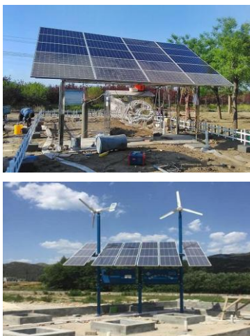
图 4-75 污水处理设施上的光伏发电板
